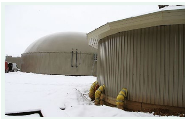
AS "Agrofirma "Tērvete"" liellopu kompleksa biogāzes radīto siltumu izmanto alus brūzī un ciemata apkurei. Foto – Valdis Semjonous
