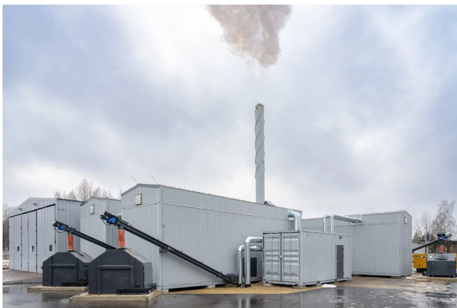
2.2.1.2.5. attēls. „Olaines ūdens un siltuma” jaunā katlumāja
