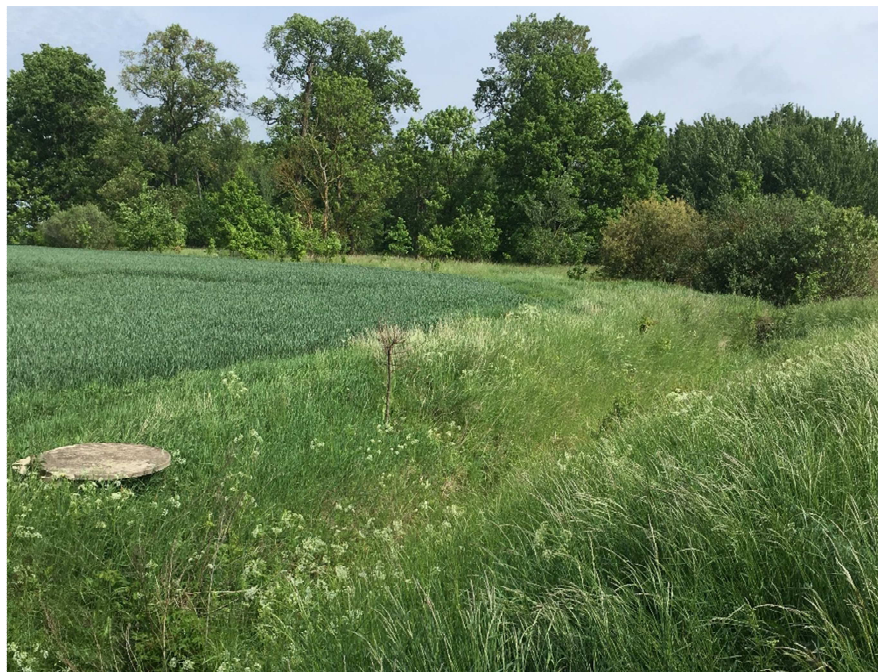
45.att. Skats no Bēzres 1.vietas grāvja kreisā krasta uz aku un caurteku grāvja sākumā.
