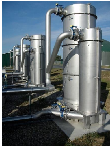
att. 4.3. Biogāzes desulfurizācijas iekārta 39 .
